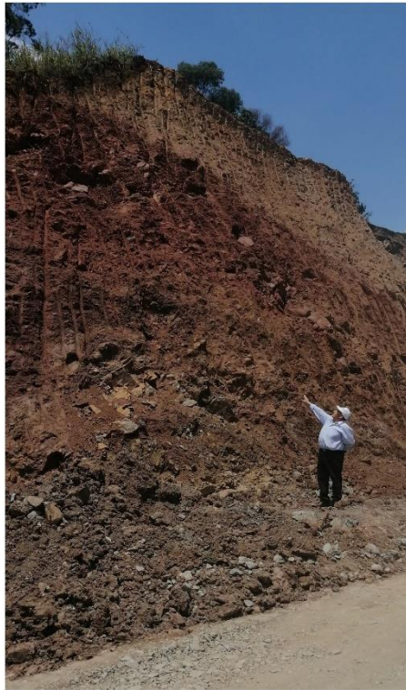
Figura 8. Corte de talud en vía evitamiento.
